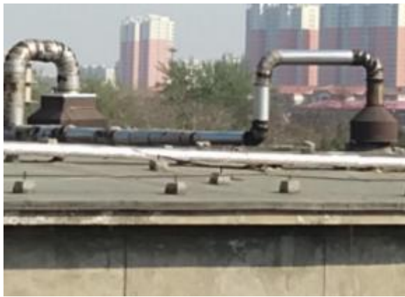
车间顶部废气收集管网
