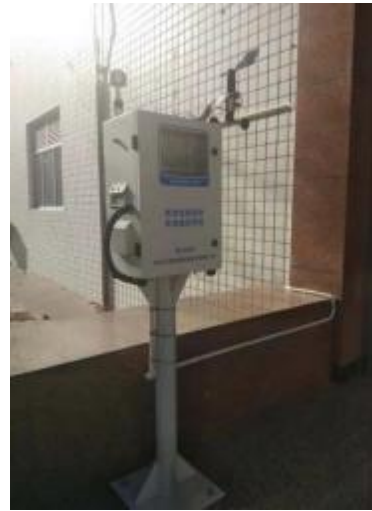
片基二部车间门口 VOC 超标报警装置
