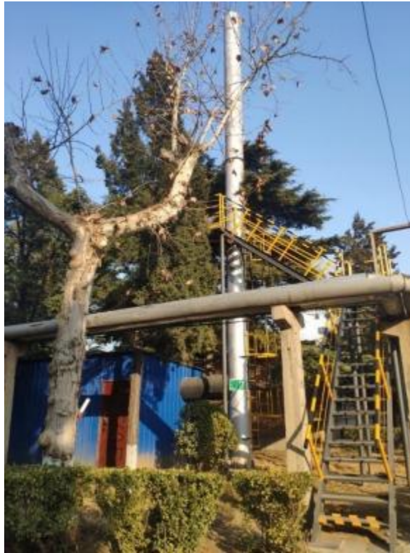
15m 高排气筒
