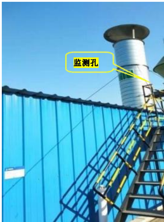
20m 高排气筒
