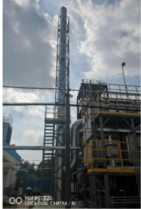
20m 高排气筒
