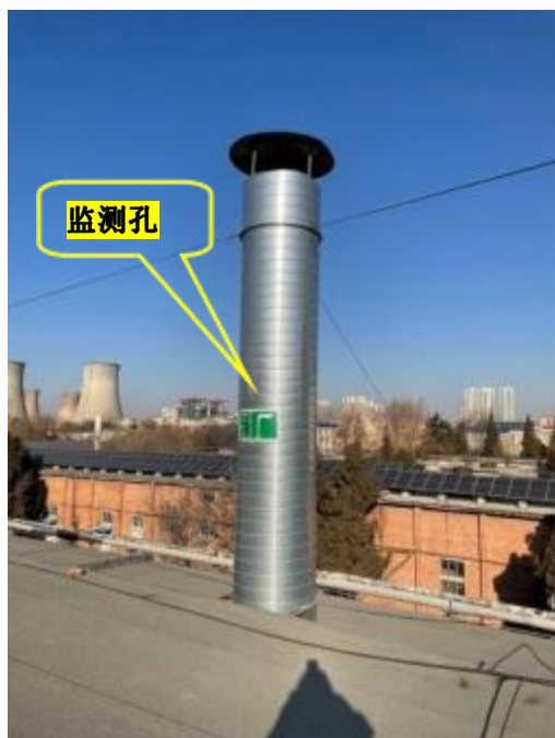
(5) 有机中试线(西侧)实验有机废气排气筒 (DA006)
