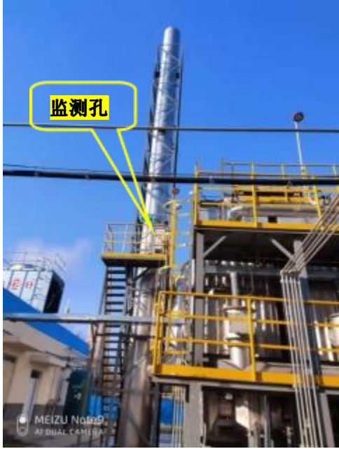
20m 高排气筒
