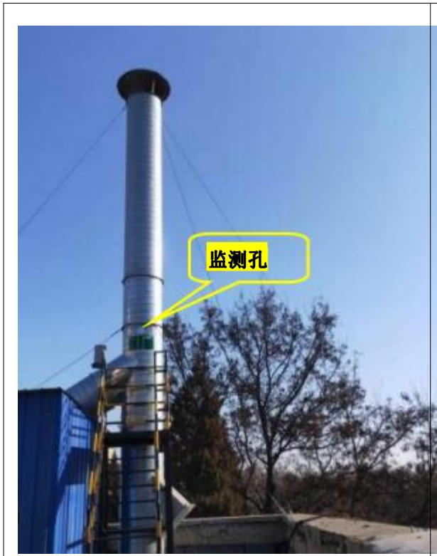
20m 高排气筒
