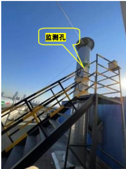
30m 高排气筒
