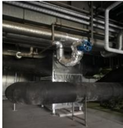
应急排气口管道收集
