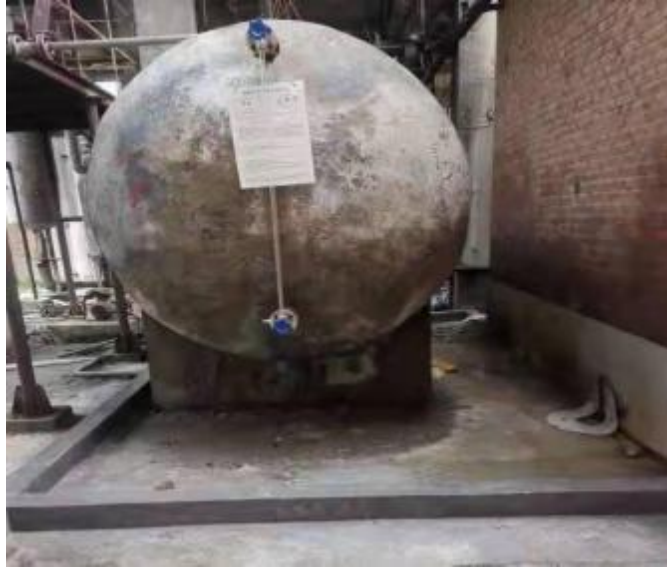
储罐区防渗、耐腐蚀围堰
